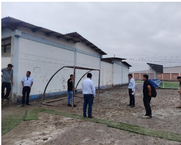
Foto N° 06: INSPECCIÓN DE LAS INSTALACIONES DE LA I.E. N.° 81024 MIGUEL GRAU SEMINARIO, DONDE SE EVIDENCIÓ EL DETERIORO DE LA INFRAESTRUCTURA Y FILTRACIONES DE AGUA EN EL ÁREA DEL PATIO, AFECTANDO LAS CONDICIONES DE SEGURIDAD Y USO DE LOS ESPACIOS EDUCATIVOS.
