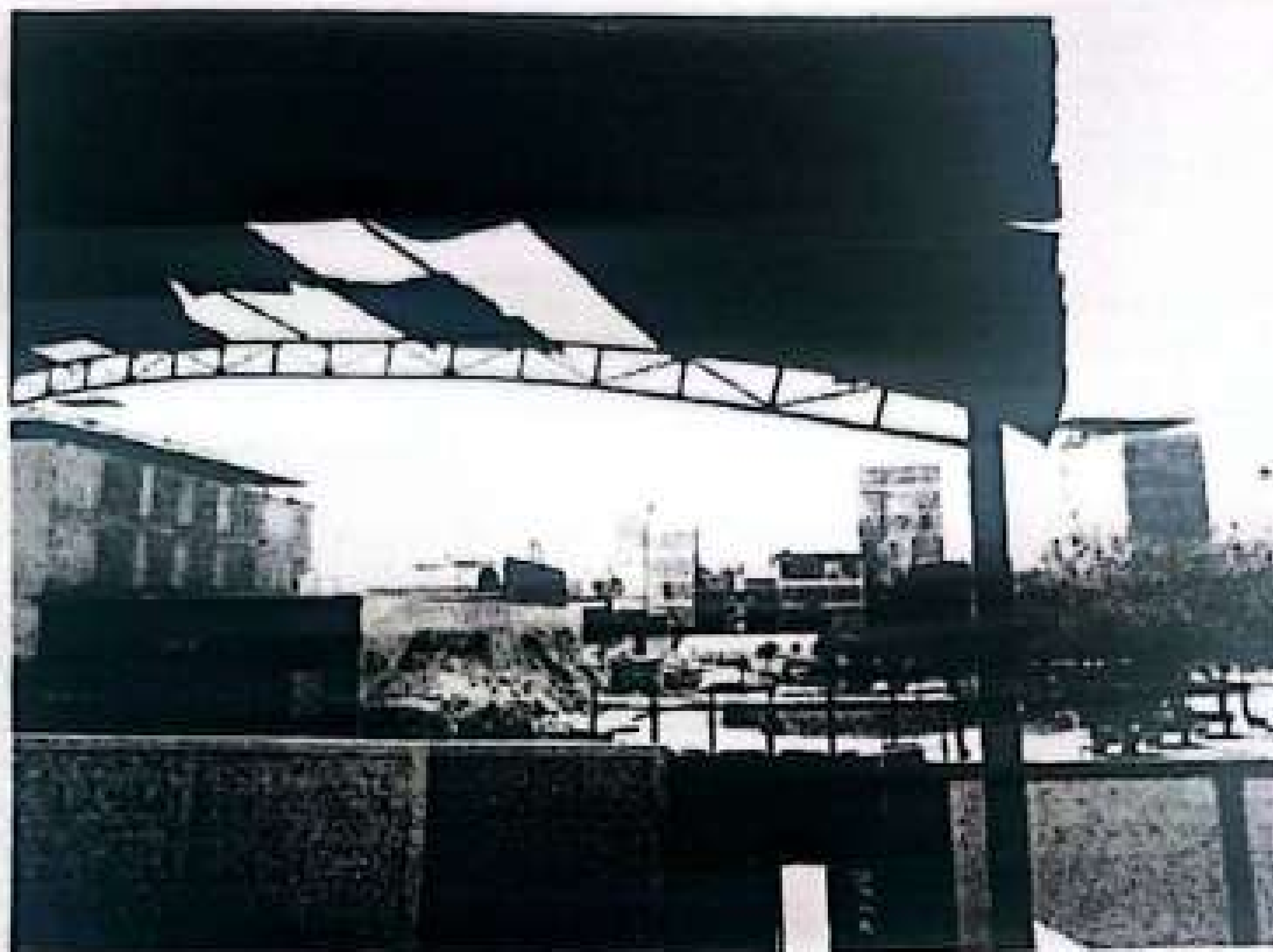
Fotografía 9: Se evidencia dañar total parcial y riesgo de desprendimiento de la cobertura de polipropileno instalada sobre la estructura metálica.
