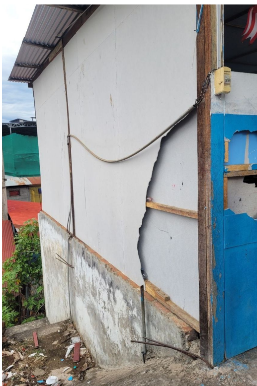
Techos y paredes de triplay deteriorados en la I.E. «Aurora»
