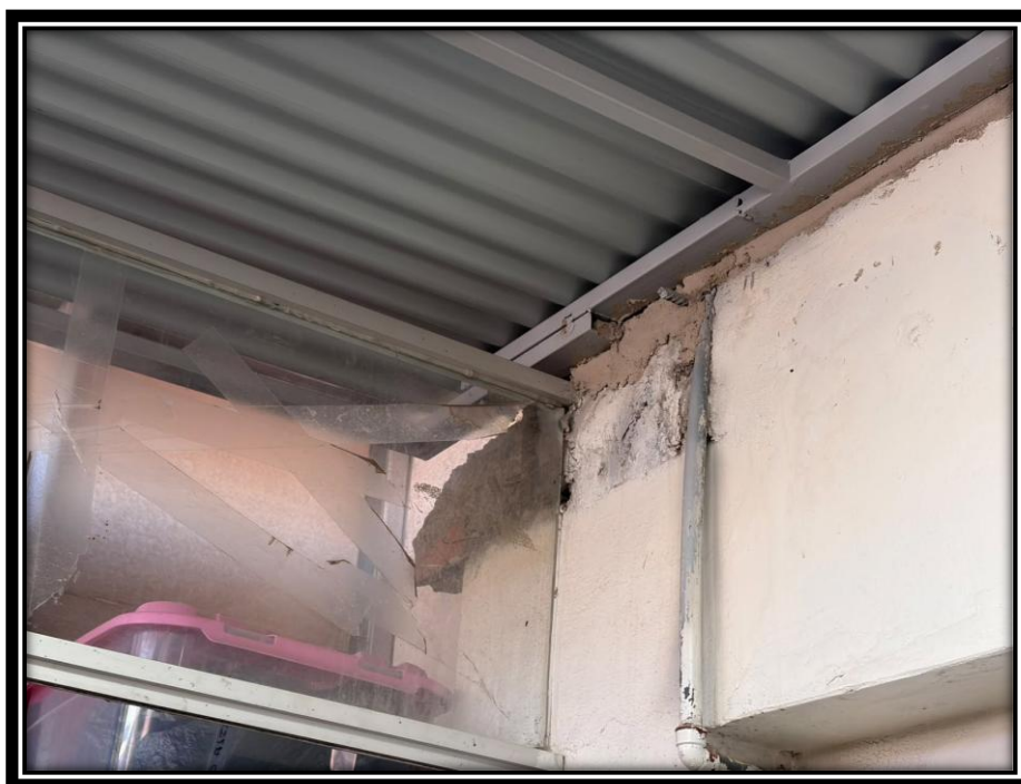
Fotografía 11. Detalle de las filtraciones y el deterioro observados en la cobertura y el muro del local escolar.
