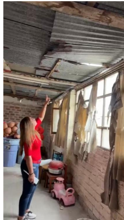
Registro de un sector con cobertura y acabados deteriorados observado durante el recorrido.
